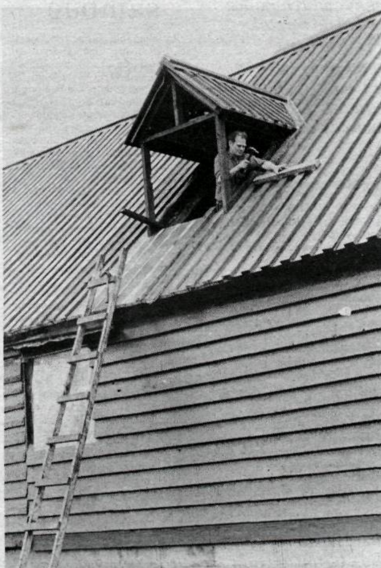
Auðunn Einarsson, kennari á Egilsstöðum, hefur mikið starfað við endurbyggingu Gömlu Búðar. Á þessari mynd sést hann teygja sig út úr kvisti á þaki hússins.
